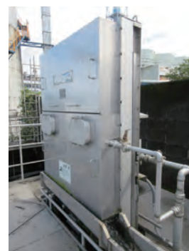
排水ビニール粕除去設備
